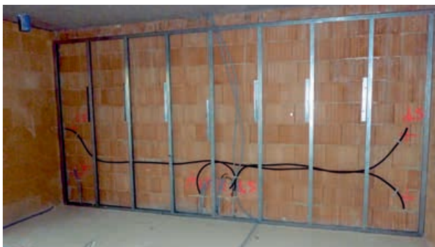
6 | Vorwandinstallation an einer Außenwand. Diese sollte eigentlich mit einem Glattstrich versehen werden.
